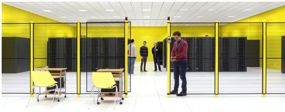
Misure di sicurezza interne al data center
